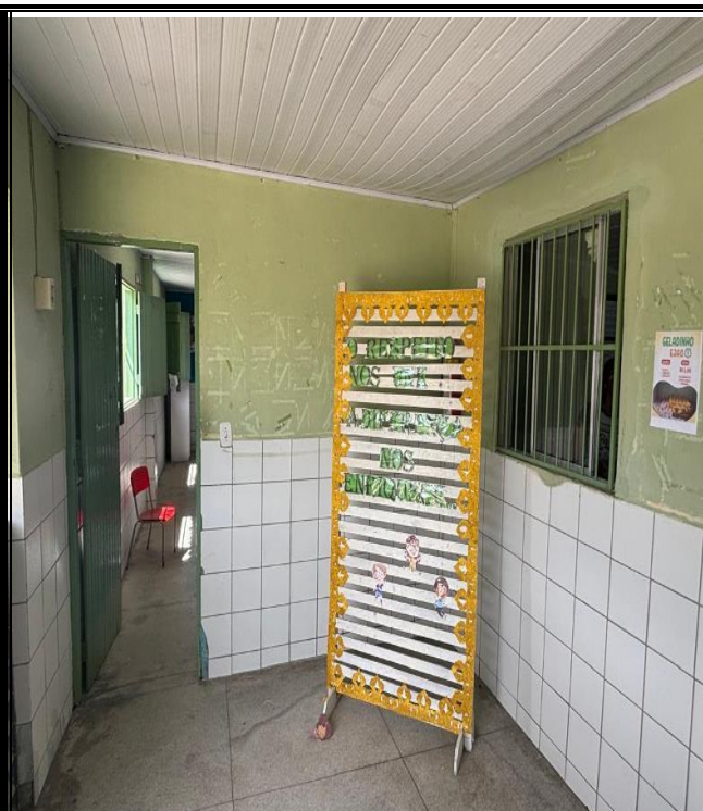
Foto 10: SITUAÇÃO ATUAL DA PINTURA DAS PAREDES INTERNAS E EXTERNAS.
