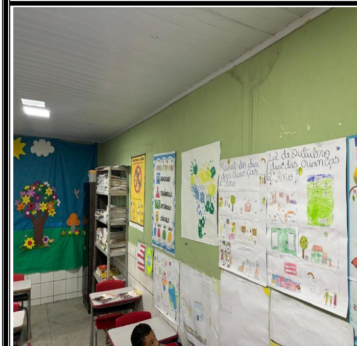
Foto 11: SITUAÇÃO ATUAL DA PINTURA DAS PAREDES INTERNAS E EXTERNAS.
