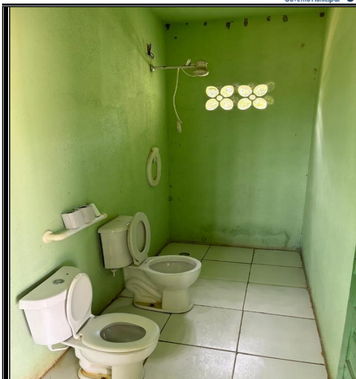
Foto 9: SITUAÇÃO ATUAL DA PINTURA DAS PAREDES INTERNAS E EXTERNAS.
