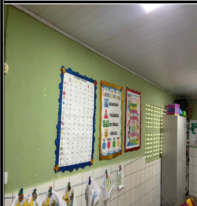
Foto 12: SITUAÇÃO ATUAL DA PINTURA DAS PAREDES INTERNAS E EXTERNAS.
