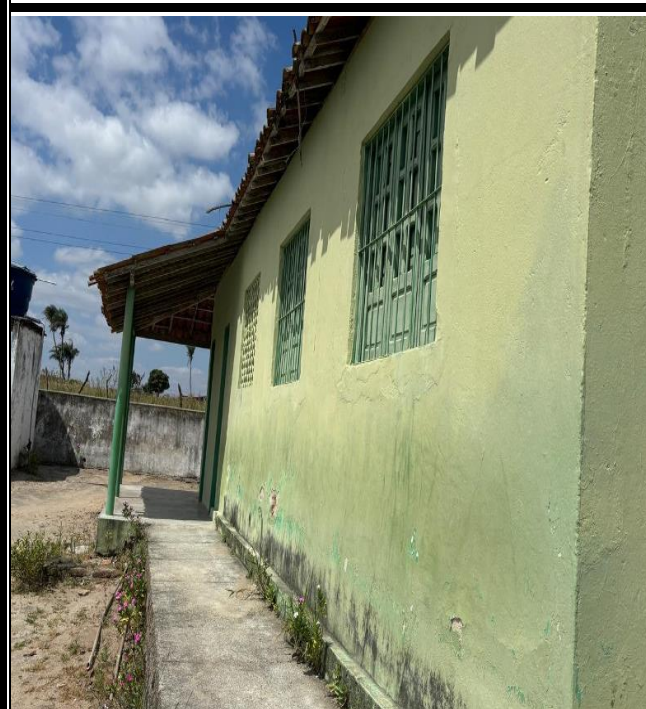
Foto 4: SITUAÇÃO ATUAL DA PINTURA DAS PAREDES INTERNAS E EXTERNAS.
