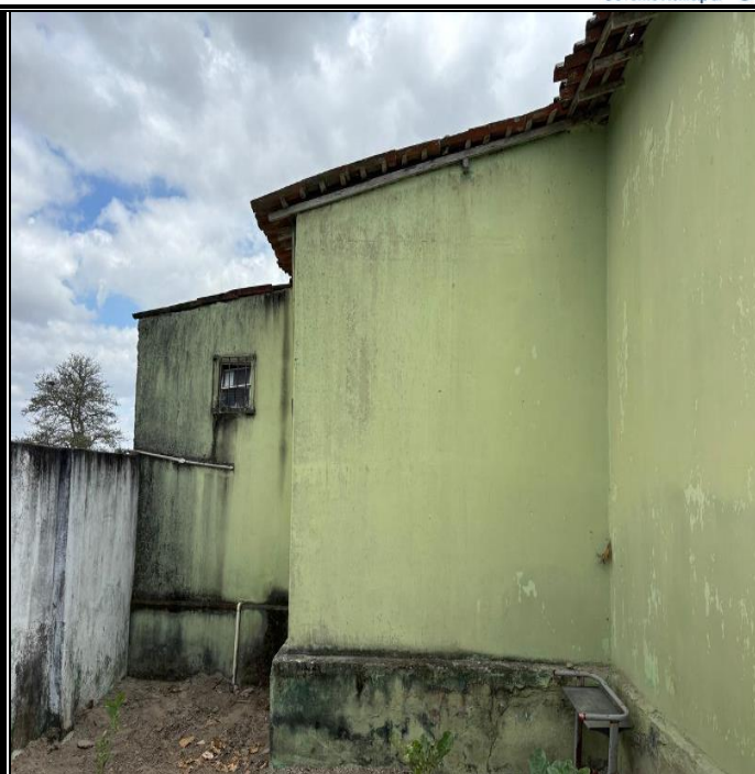
Foto 5: SITUAÇÃO ATUAL DA PINTURA DAS PAREDES INTERNAS E EXTERNAS.
