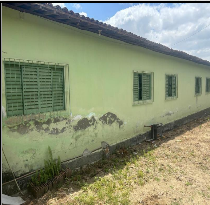
Foto 9: SITUAÇÃO ATUAL DA PINTURA DAS PAREDES INTERNAS E EXTERNAS.
