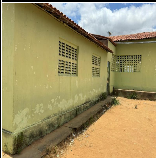
Foto 4: SITUAÇÃO ATUAL DA PINTURA DAS PAREDES INTERNAS E EXTERNAS.
