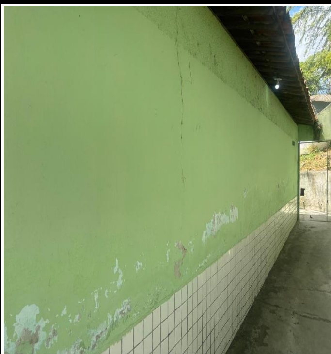
Foto 15: SITUAÇÃO ATUAL DA PINTURA DAS PAREDES INTERNAS E EXTERNAS.
