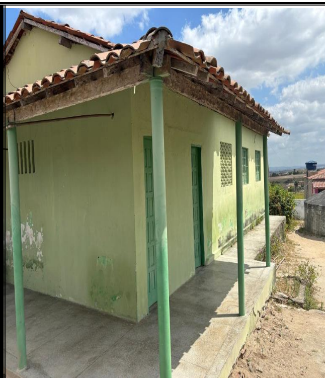
Foto 2: SITUAÇÃO ATUAL DA PINTURA DAS PAREDES INTERNAS E EXTERNAS.
