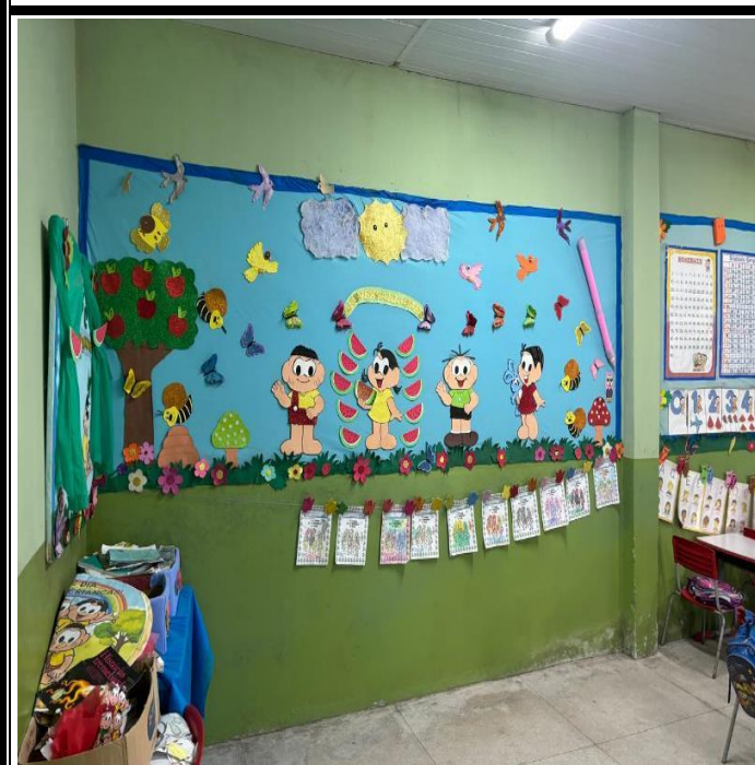
Foto 15: SITUAÇÃO ATUAL DA PINTURA DAS PAREDES INTERNAS E EXTERNAS.
