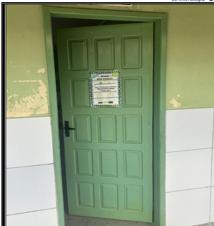
Foto 5: SITUAÇÃO ATUAL DA PINTURA DAS ESQUADRIAS DE MADEIRA E METÁLICA
