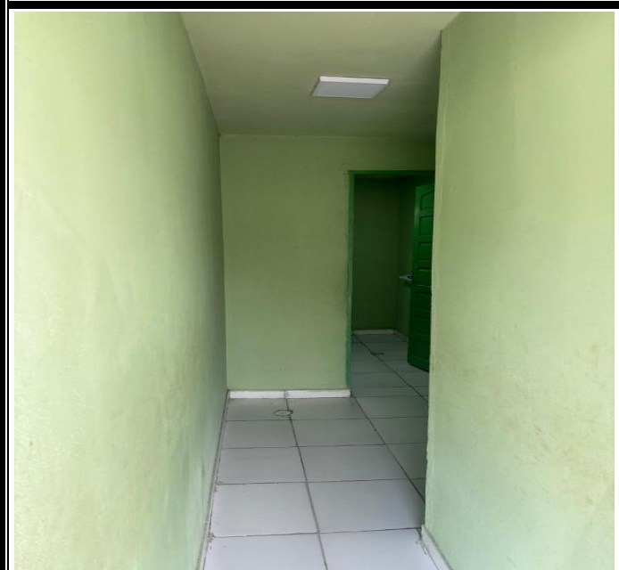
Foto 7: SITUAÇÃO ATUAL DA PINTURA DAS PAREDES INTERNAS E EXTERNAS.
