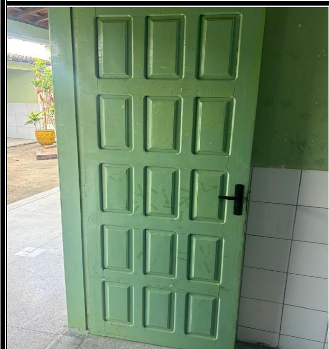
Foto 8: SITUAÇÃO ATUAL DA PINTURA DAS ESQUADRIAS DE MADEIRA E METÁLICA
