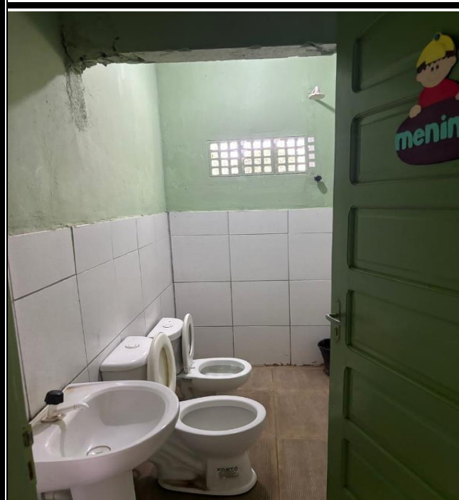
Foto 12: SITUAÇÃO ATUAL DA PINTURA DAS PAREDES INTERNAS E EXTERNAS.
