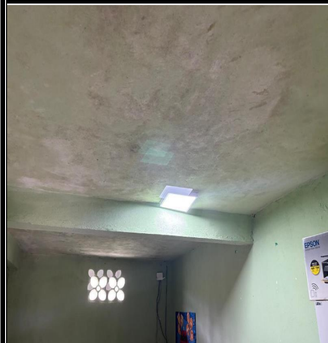
Foto 8: SITUAÇÃO ATUAL DA PINTURA DAS PAREDES INTERNAS E EXTERNAS.
