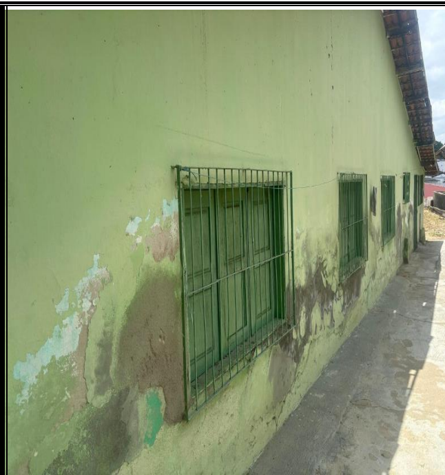
Foto 10: SITUAÇÃO ATUAL DA PINTURA DAS PAREDES INTERNAS E EXTERNAS.
