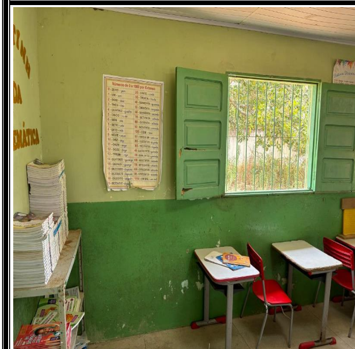
Foto 11: SITUAÇÃO ATUAL DA PINTURA DAS PAREDES INTERNAS E EXTERNAS.
