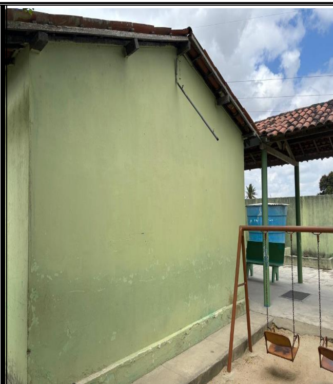
Foto 6: SITUAÇÃO ATUAL DA PINTURA DAS PAREDES INTERNAS E EXTERNAS.
