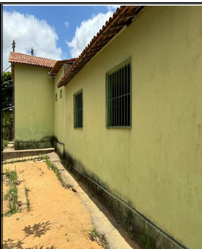
Foto 2: SITUAÇÃO ATUAL DA PINTURA DAS PAREDES INTERNAS E EXTERNAS.
