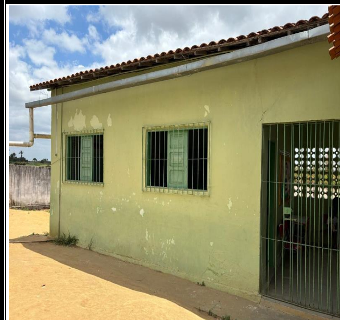
Foto 3: SITUAÇÃO ATUAL DA PINTURA DAS PAREDES INTERNAS E EXTERNAS.
