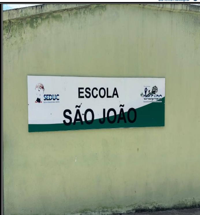
Foto 1: SITUAÇÃO ATUAL DA PINTURA DAS PAREDES INTERNAS E EXTERNAS.
