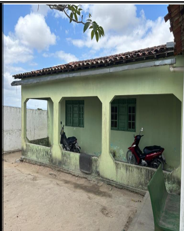
Foto 2: SITUAÇÃO ATUAL DA PINTURA DAS PAREDES INTERNAS E EXTERNAS.
