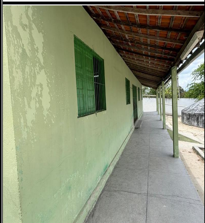
Foto 8: SITUAÇÃO ATUAL DA PINTURA DAS PAREDES INTERNAS E EXTERNAS.
