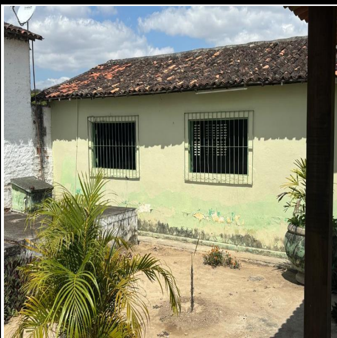
Foto 3: SITUAÇÃO ATUAL DA PINTURA DAS PAREDES INTERNAS E EXTERNAS.
