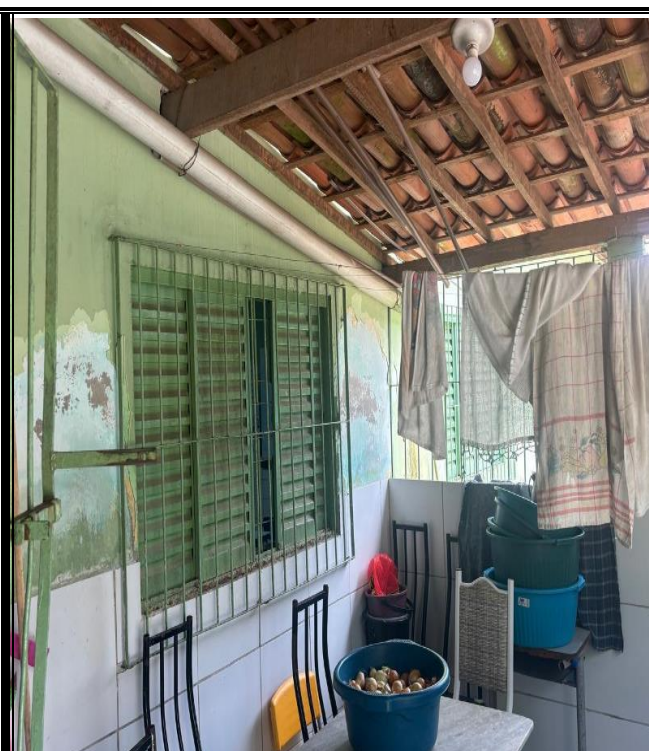
Foto 6: SITUAÇÃO ATUAL DA PINTURA DAS ESQUADRIAS DE MADEIRA E METÁLICA
