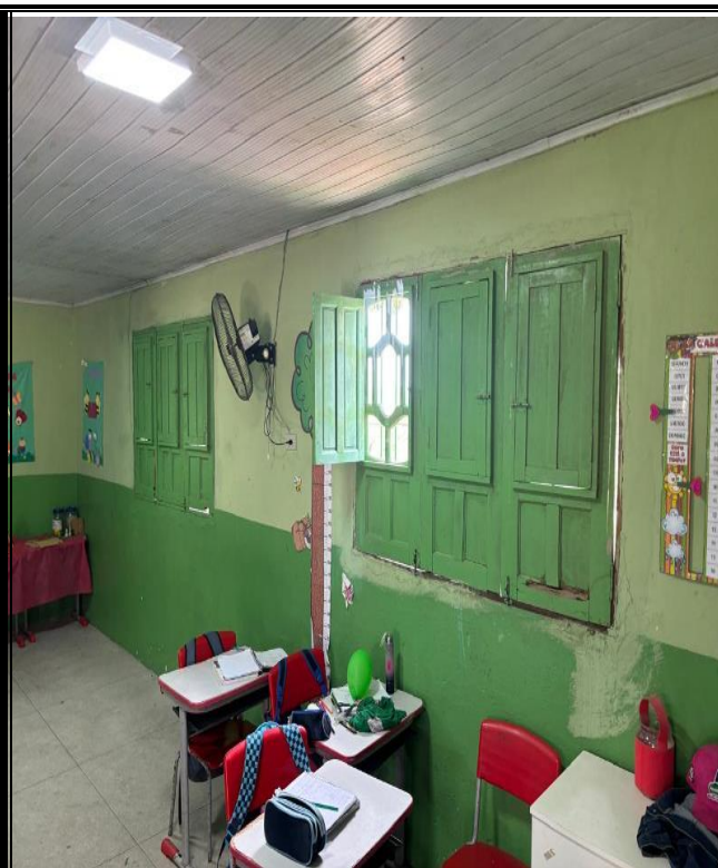
Foto 6: SITUAÇÃO ATUAL DA PINTURA DAS PAREDES INTERNAS E EXTERNAS.
