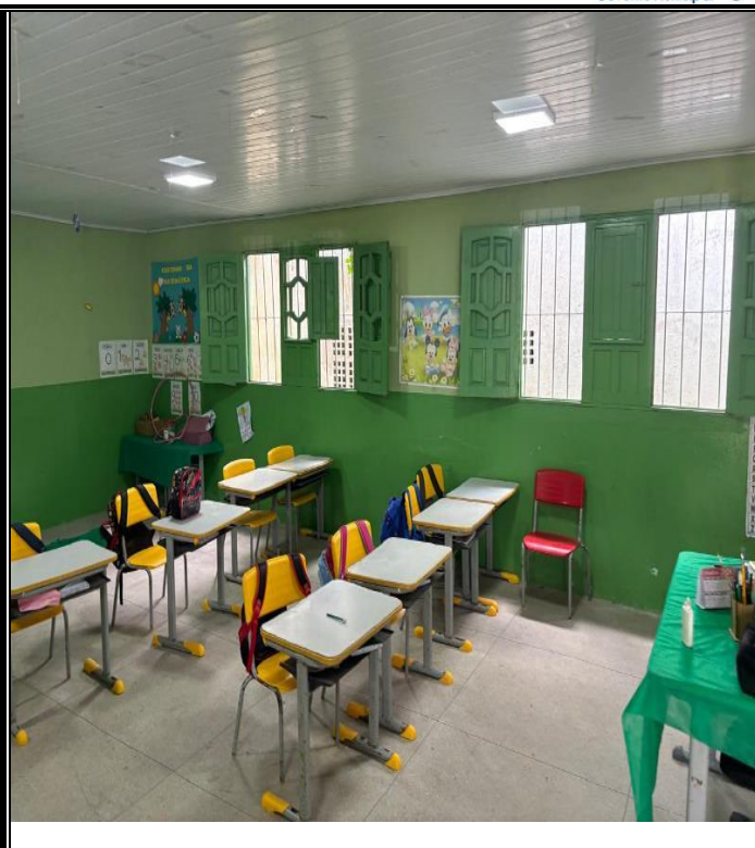
Foto 5: SITUAÇÃO ATUAL DA PINTURA DAS PAREDES INTERNAS E EXTERNAS.
