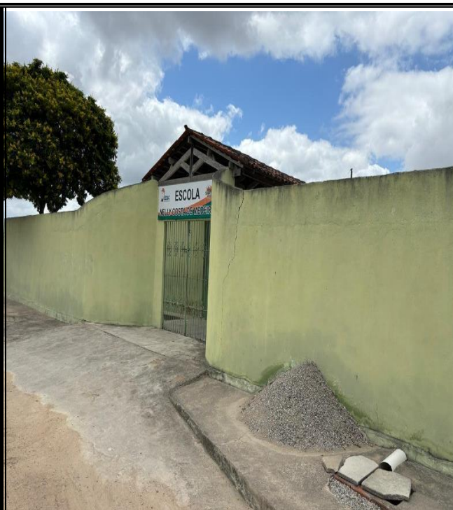
Foto 2: SITUAÇÃO ATUAL DA PINTURA DAS PAREDES INTERNAS E EXTERNAS.
