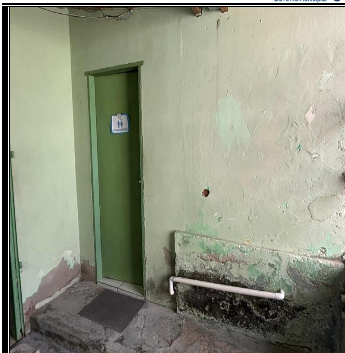
Foto 13: SITUAÇÃO ATUAL DA PINTURA DAS PAREDES INTERNAS E EXTERNAS.
