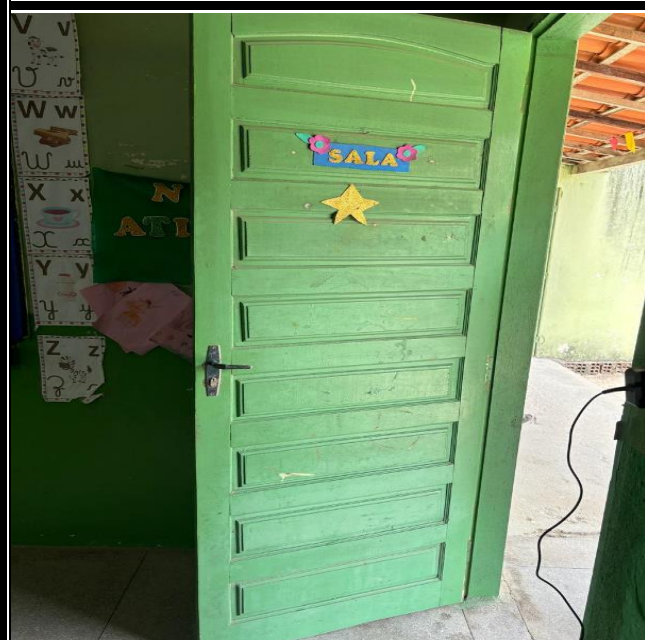
Foto 8: SITUAÇÃO ATUAL DA PINTURA DAS ESQUADRIAS DE MADEIRA E METÁLICA
