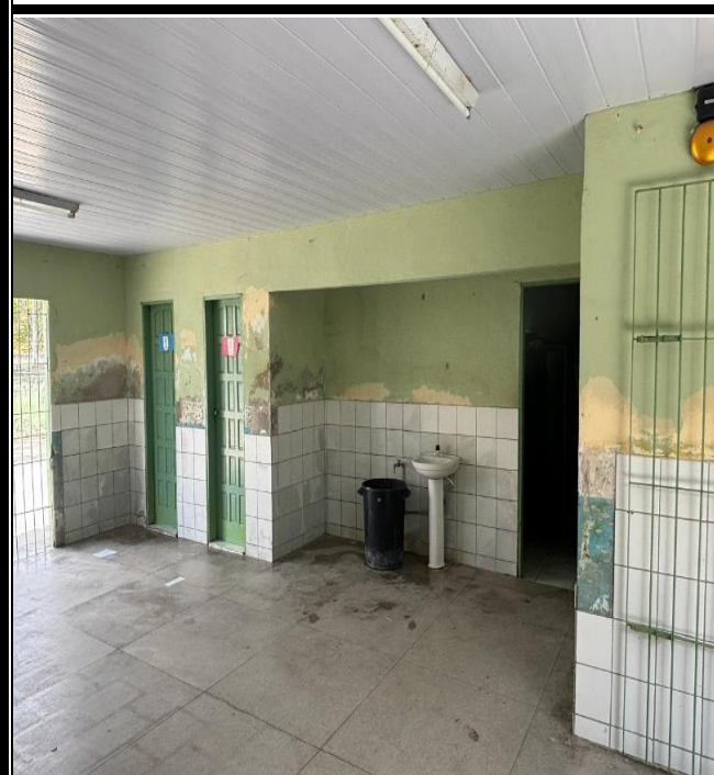
Foto 16: SITUAÇÃO ATUAL DA PINTURA DAS PAREDES INTERNAS E EXTERNAS.
