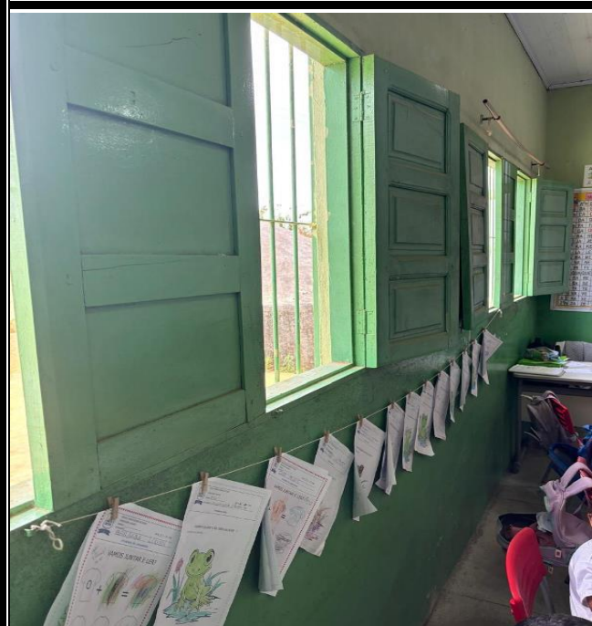
Foto 12: SITUAÇÃO ATUAL DA PINTURA DAS ESQUADRIAS DE MADEIRA E METÁLICA
