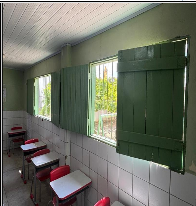
Foto 9: SITUAÇÃO ATUAL DA PINTURA DAS ESQUADRIAS DE MADEIRA E METÁLICA
