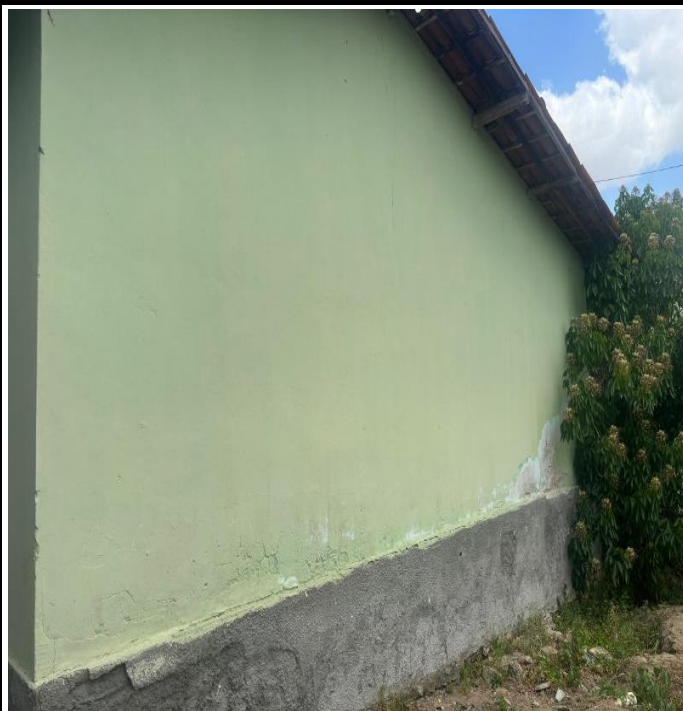
Foto 11: SITUAÇÃO ATUAL DA PINTURA DAS PAREDES INTERNAS E EXTERNAS.
