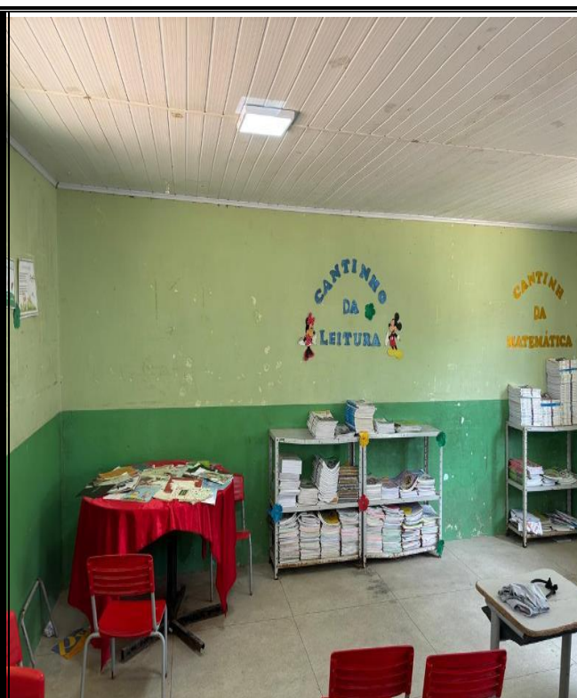
Foto 10: SITUAÇÃO ATUAL DA PINTURA DAS PAREDES INTERNAS E EXTERNAS.
