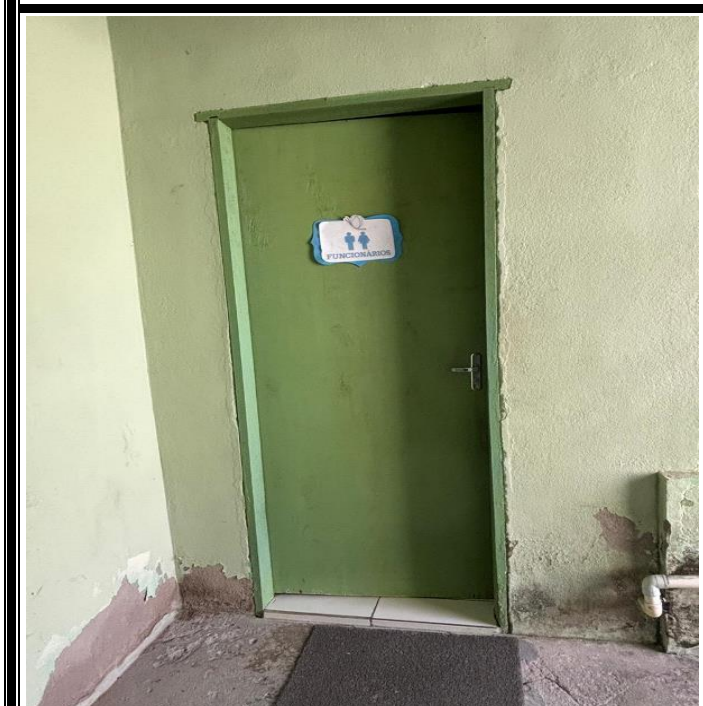
Foto 15: SITUAÇÃO ATUAL DA PINTURA DAS ESQUADRIAS DE MADEIRA E METÁLICA
