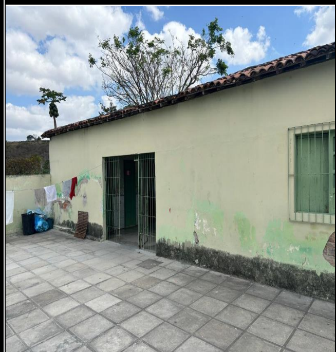
Foto 4: SITUAÇÃO ATUAL DA PINTURA DAS PAREDES INTERNAS E EXTERNAS.
