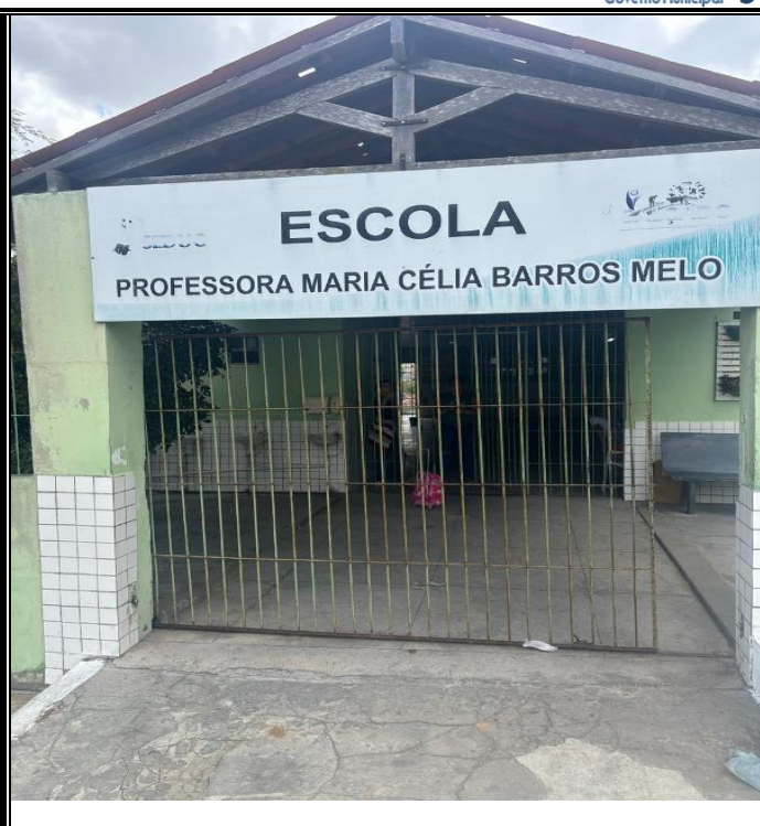
Foto 1: SITUAÇÃO ATUAL DA PINTURA DAS PAREDES INTERNAS E EXTERNAS.
