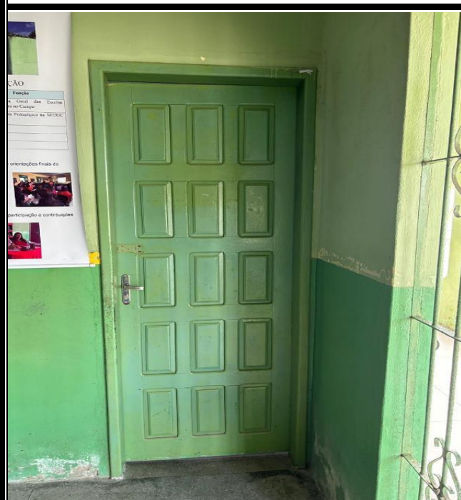
Foto 16: SITUAÇÃO ATUAL DA PINTURA DAS ESQUADRIAS DE MADEIRA E METÁLICA.
