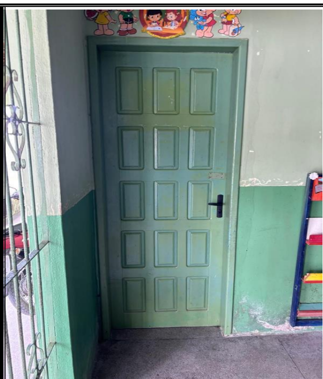
Foto 10: SITUAÇÃO ATUAL DA PINTURA DAS ESQUADRIAS DE MADEIRA E METÁLICA
