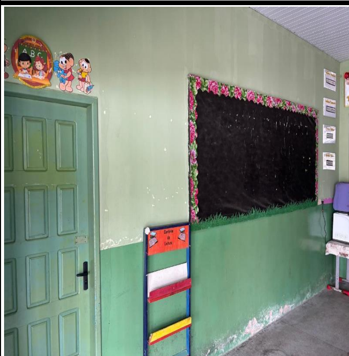
Foto 7: SITUAÇÃO ATUAL DA PINTURA DAS PAREDES INTERNAS E EXTERNAS.
