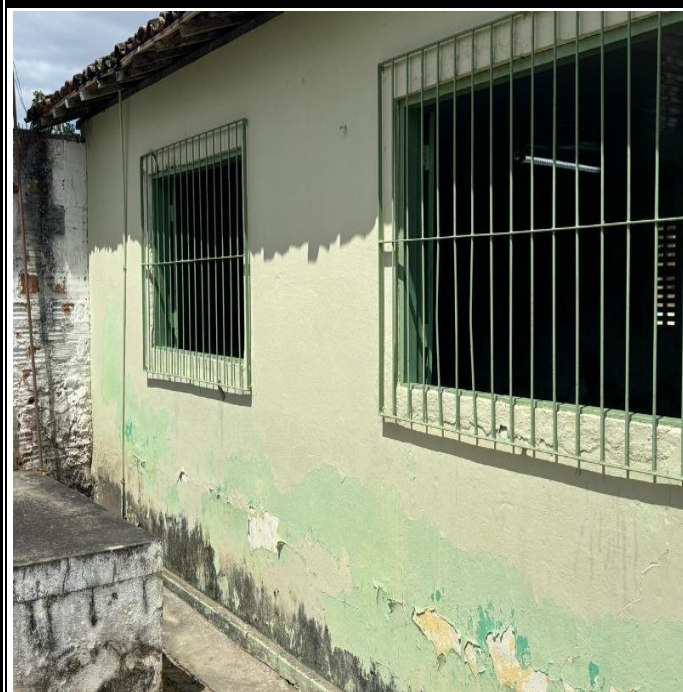
Foto 7: SITUAÇÃO ATUAL DA PINTURA DAS ESQUADRIAS DE MADEIRA E METÁLICA
