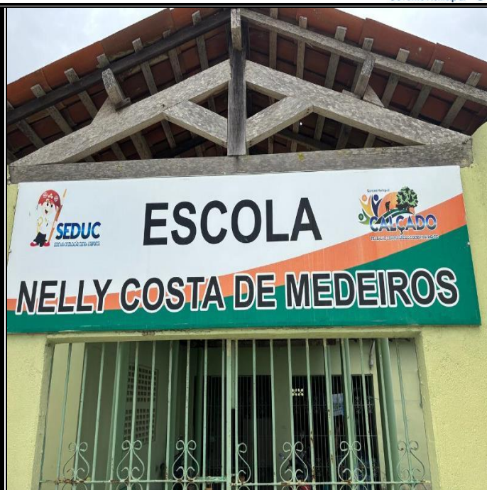
Foto 1: SITUAÇÃO ATUAL DA PINTURA DAS PAREDES INTERNAS E EXTERNAS.
