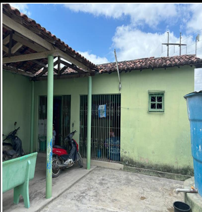
Foto 3: SITUAÇÃO ATUAL DA PINTURA DAS PAREDES INTERNAS E EXTERNAS.
