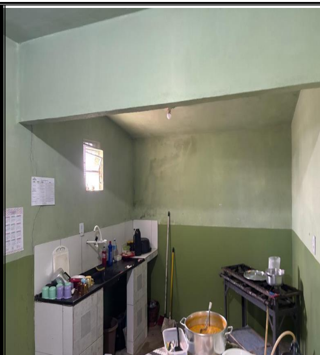
Foto 14: SITUAÇÃO ATUAL DA PINTURA DAS PAREDES INTERNAS E EXTERNAS.
