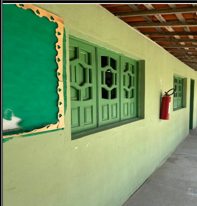
Foto 4: SITUAÇÃO ATUAL DA PINTURA DAS ESQUADRIAS DE MADEIRA E METÁLICA
